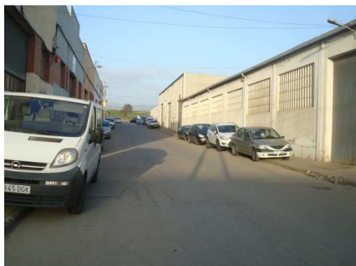
Estat del ferm c. Canigó.
